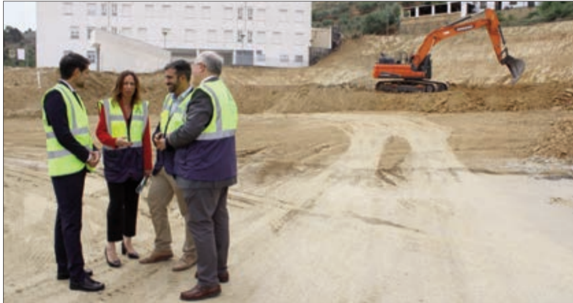
La delegada de Fomento, Rocío Díaz, visita el inicio de las obras de la Estación de Loja en la zona de El Mantillo. FOTO: C. MOLINA
