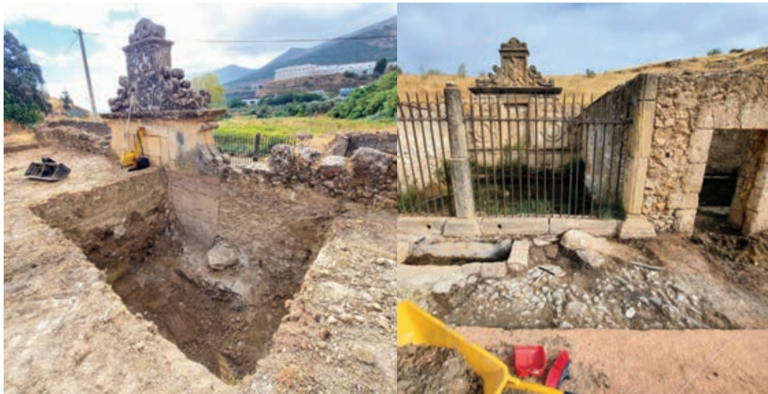
A la izquierda, excavación en la parte posterior del monumento, que quedó sepultada por aportes de tierra modernos. A la derecha, trabajos en la parte delantera. FOTOS: CULTURA
