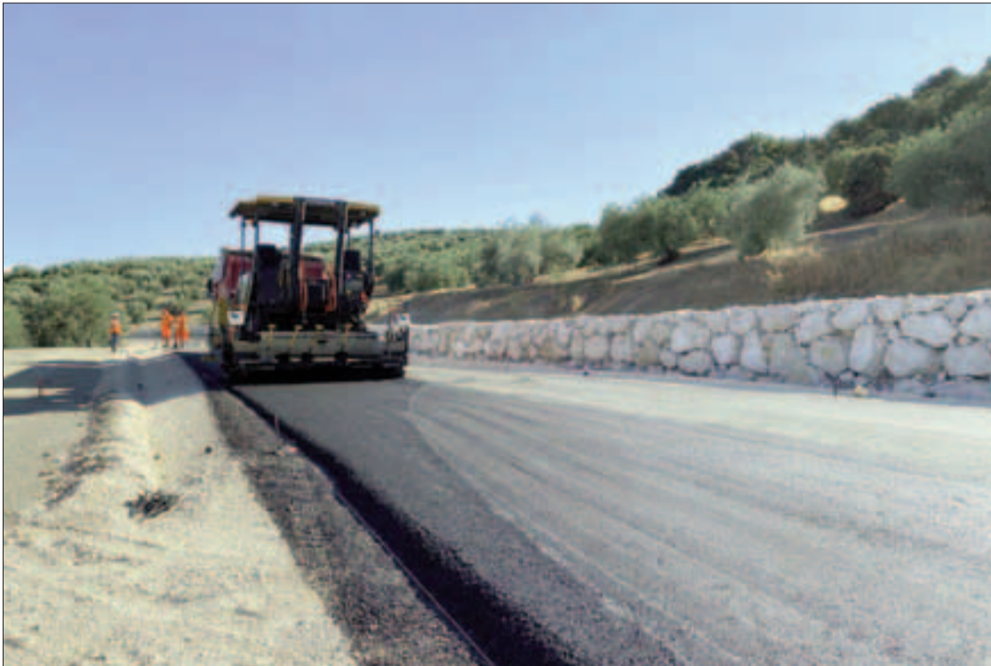
Uno de los tramos de la carretera entre Loja y Ventorros de San José que se está asfaltando. FOTO: EL CORTO
