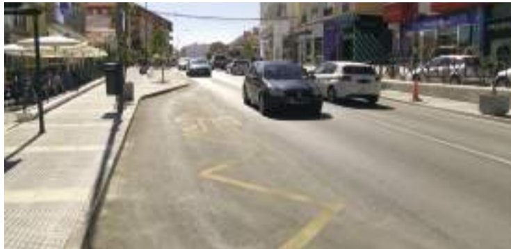
Estado de la travesía de entrada a Loja en Avenida Pérez del Álamo. EL CORTO.
