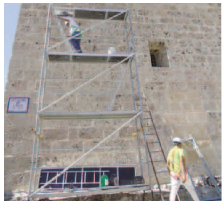
Momento de la colocación del andamio de acceso a la torre. FOTO: CARLOS MOLINA
